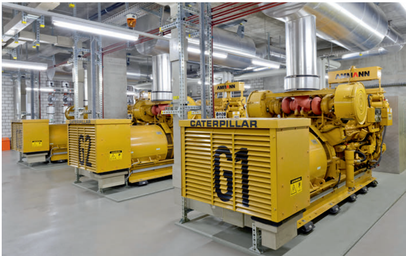
Das Kernstück der Notstromversorgung bilden drei Caterpillar-Dieselegeneratoren mit einer Leistung von je 1250 kVA.
